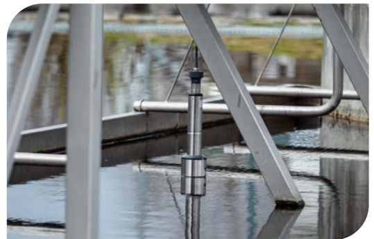
Abb. 4: Typischer Einsatzort des IFL 700 IQ an einer Räumernbrücke im Nachklärbecken
